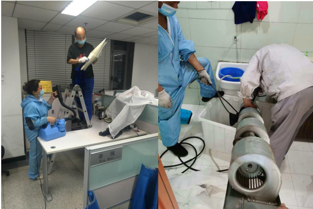
图 11 中央空调系统清洗
