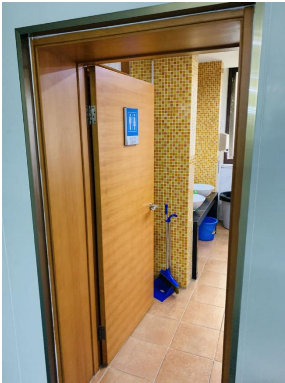
图 3 红楼卫生间改造前
